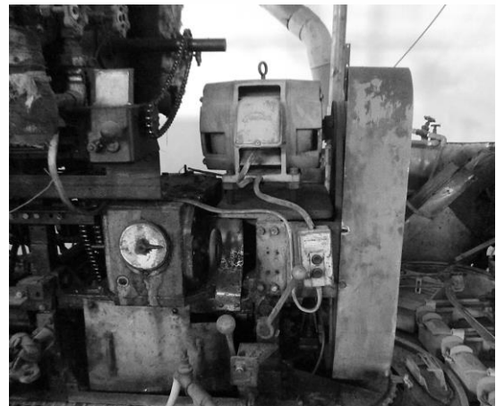
電気モーターや変速機を備える原動部
